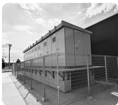
道の駅赤城に設置された「浸水対策された給電施設」
