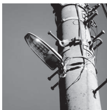
LED化された防犯灯
