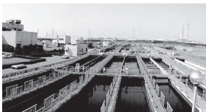
効率的な広域協同処理を行っている「君津富津終末処理場」
