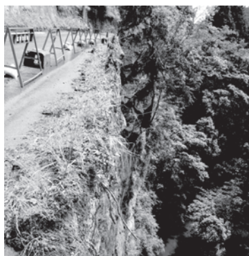
路肩が崩落した林道志組線の現状
