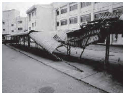
台風により破損した大貫中学校自転車置場
