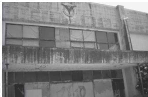
立ち入り禁止となっている旧社会体育館
