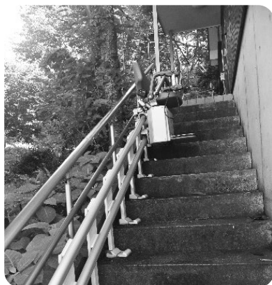
居宅の屋外階段に取り付けられた「いす式階段昇降機」
