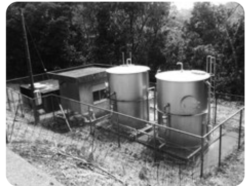
山中奥畑簡易給水施設
