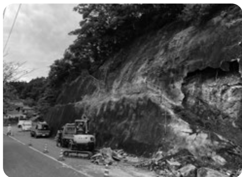
令和2年10月に崩落した市道松原下堀切線の様子
