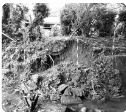
崩落した山入川の護岸の様子
