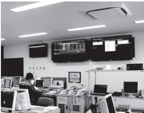
最新の消防指令端末装置が設置されています。
